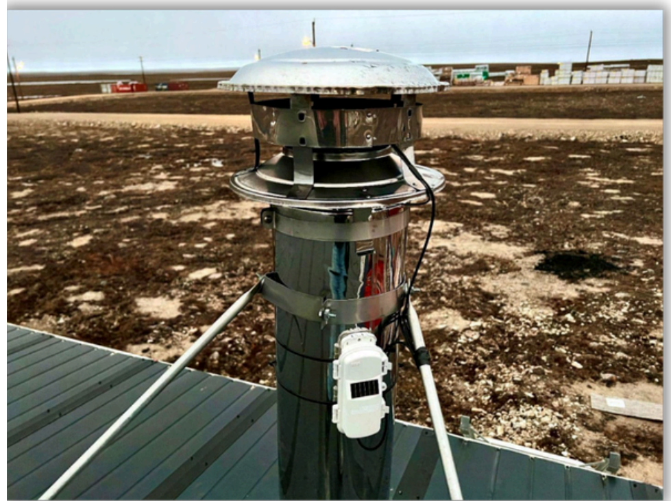
Fig. 1. Capteur de température/humidité sur la cheminée d'évacuation de la chaudière et du chauffe-eau
